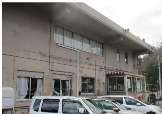
老朽化が進む川内営業所
