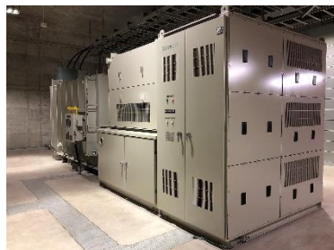
電力吸収装置
