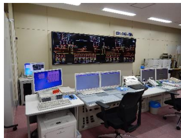
東西線電力管理システム
