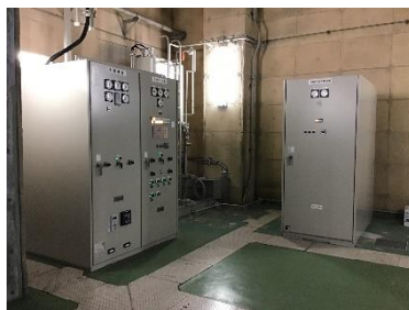
非常用発電設備（地下鉄）
